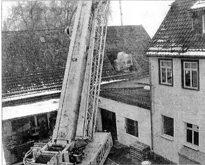
Die tonnenschwere Exzenter-Pressen zur Herstellung von Stanz- und Ziehteilen wird vom Autokran übers Dach ans Tageslicht befördert. (Fotos: jan)
